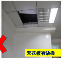
天花板有缺损
